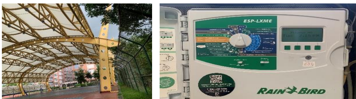
圖 2：桃園校區雨水貯留設備
